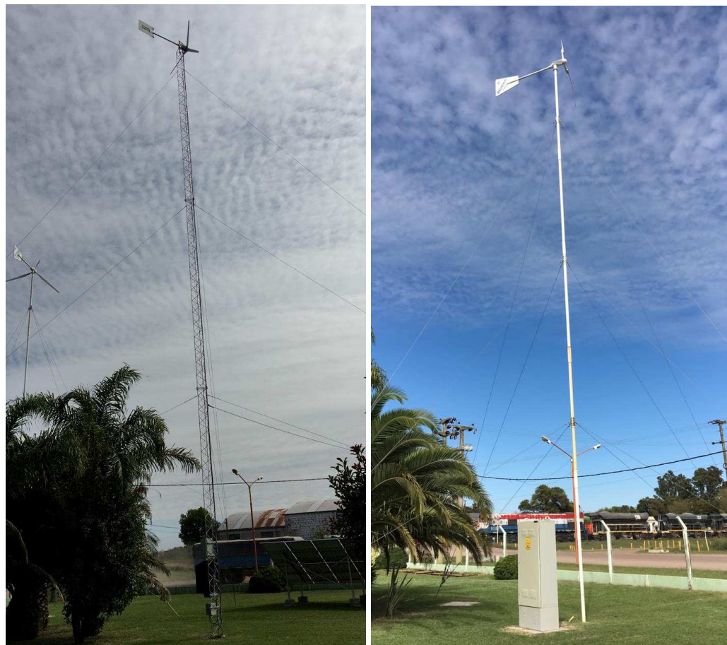
Figura 1 – Ubicación de los Aerogeneradores en Armstrong - Instalación UTN FRRo: Eolux (izq) y Wintec (der)
