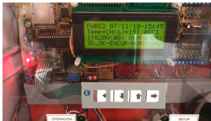
Figura 7a,b – (a) Ensayo de PWRC2 existente con módulo HV nuevo conectado, INTI CCo, 07-11-2018 , y (b) detalle del Display, todavía con indicación errónea de temperatura desde METEO 2
