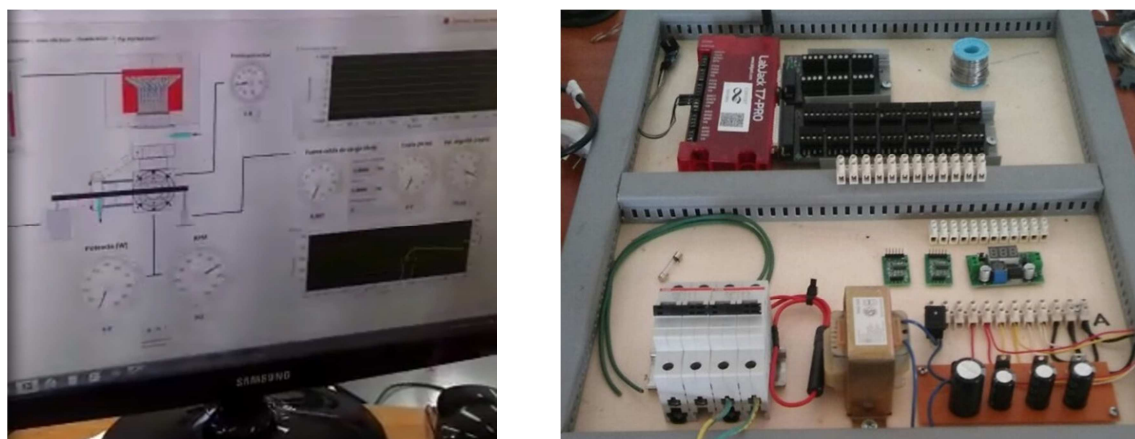
Figura 1- Imágenes de la pantalla de LabView y del tablero electrónico Fuente: Elaboración propia
